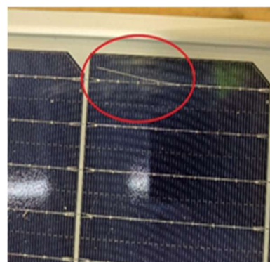
rys.3 Uszkodzony bus bar
