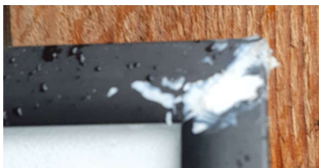
rys.5 Pozostałości silikonu z procesu produkcyjnego
