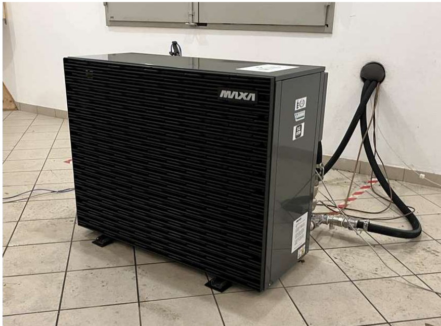
Figure 3- Panoramic of installation in the room (Rysunek 3 - Panoramiczny montaż w pomieszczeniu).
